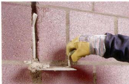
Corretto riempimento delle tracce impiantistiche.
